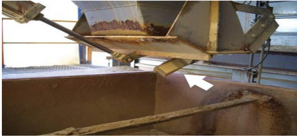
شکل ۴: سنسور رطوبت سنج نصب شده در محل ذخیره‌ی سنگدانه
